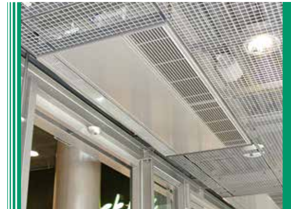
VENTILACIÓN ROOF TOP
